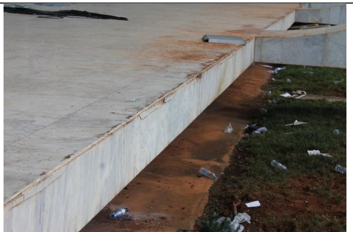
Piso com mármore danificado e manchas de pisoteamento
