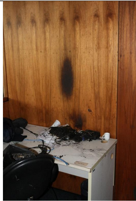
Pontos de fogo atingindo revestimentos
