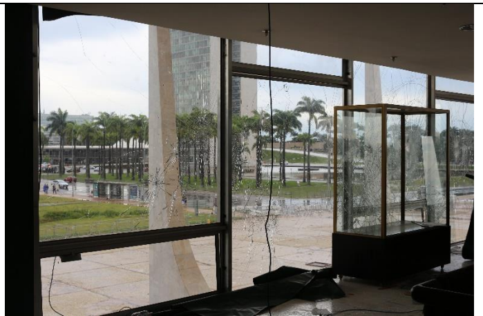
Vidros trincados e quebrados
