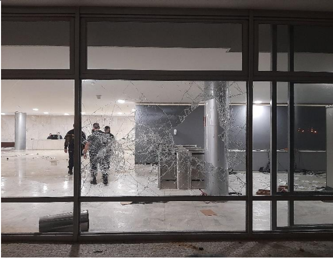
Vidros quebrados do térreo do Palácio do Planalto
