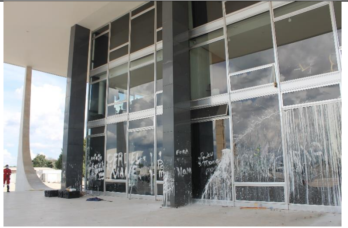
Fachada norte com pichações, esquadrias danificadas, vidros trincados e quebrados
