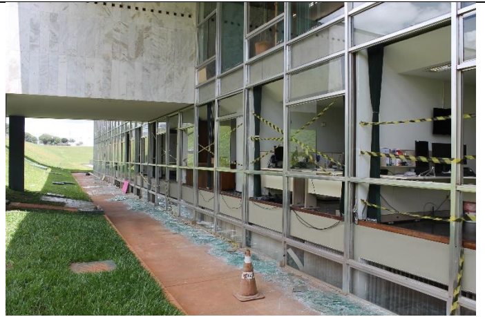
Fachada sul do Congresso, com vidraçarias completamente destruídas ao nível térreo
