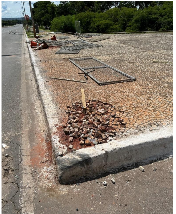
Trecho do piso com pedras portuguesas arrancadas
