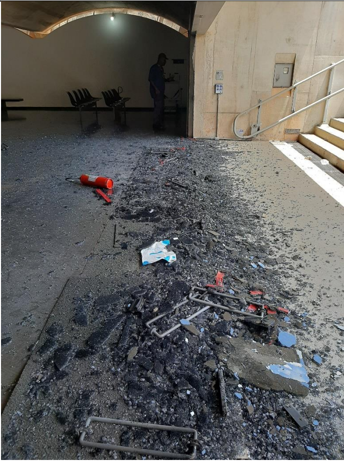
Porta de acesso de vidro integralmente quebrada
