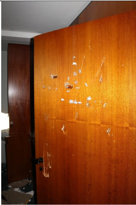
Portas arrombadas e depredadas
