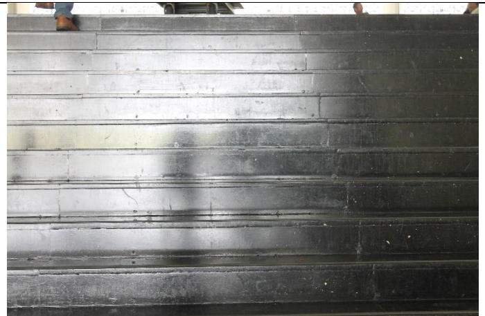
Danos à escadaria interna do Congresso Nacional
