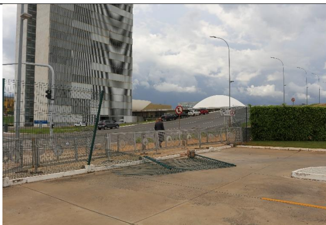
Danos ao cercamento do Palácio do Planalto
