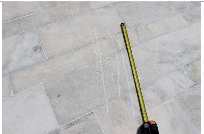
Arranhões no mármore da rampa de acesso ao Palácio do Planalto
