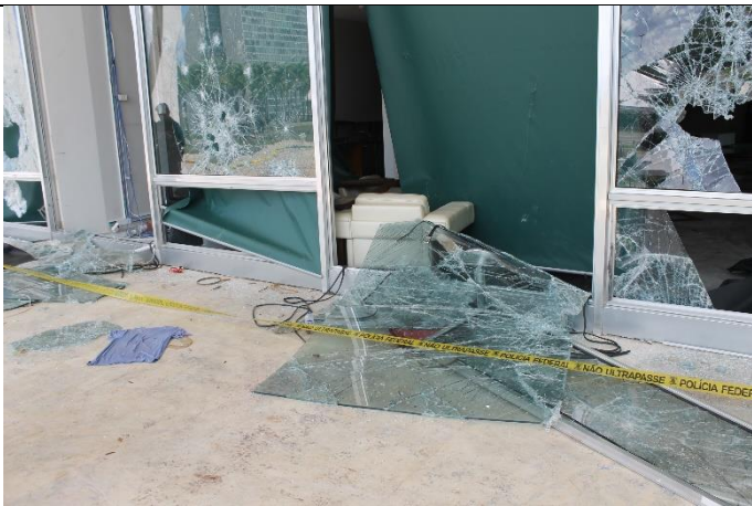
Painéis de vidro da fachada oeste trincados e quebrados
