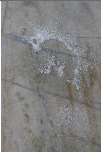
Danos ao piso de mármore em passarela de acesso ao Parlatório
