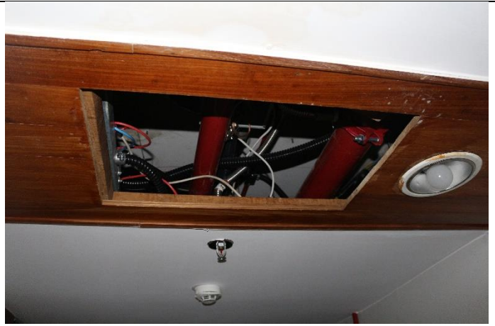
Painéis de madeira do teto vandalizados
