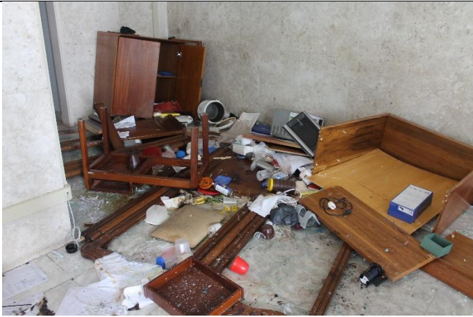
Mobiliário depredado e piso manchado
