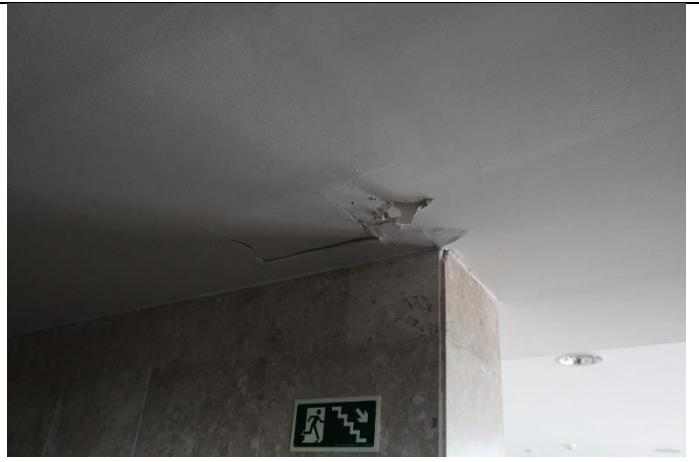
Forro de gesso danificado
