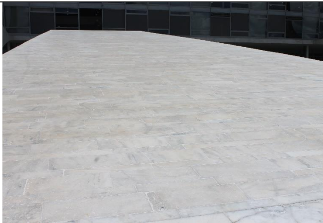
Riscos causados ao revestimento em mármore da rampa do Planalto
