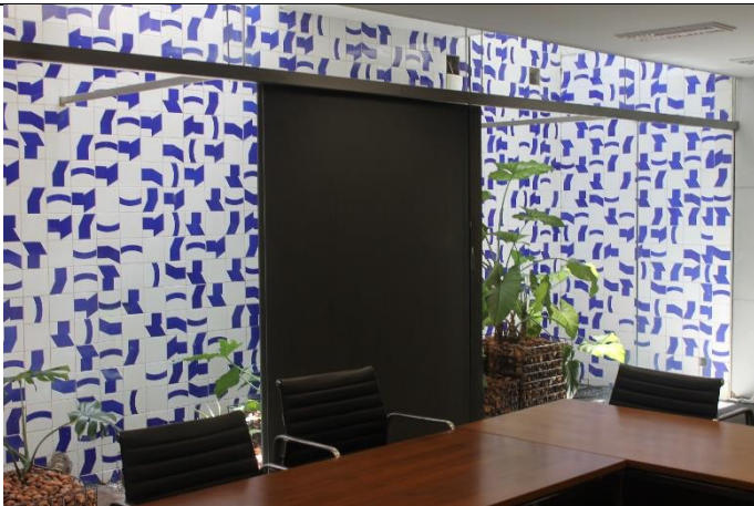
Painéis em madeira utilizados de forma provisória no lugar de esquadrias de vidro que foram vandalizadas
