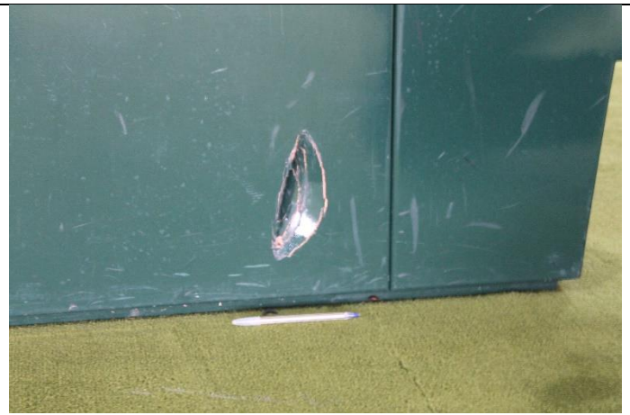
Dano no painel Muro Escultórico , de Athos Bulcão
