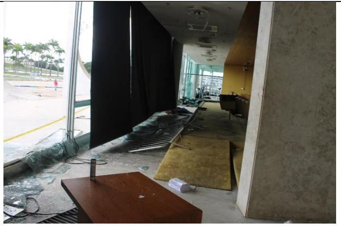
Acesso ao plenário com painéis de vidro quebrados, carpete encharcado e manchado, luminárias e mobiliário danificados
