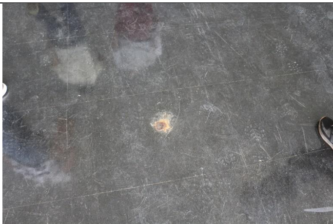
Danos em piso causados pela ação de contenção aos vândalos
