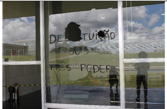
Módulo de esquadria pichado e avariado
