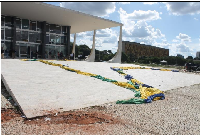
Pedras portuguesas arrancadas, com fragmentos sobre o piso de mármore
