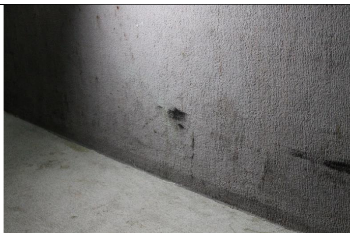
Manchas em revestimento acarpitado
