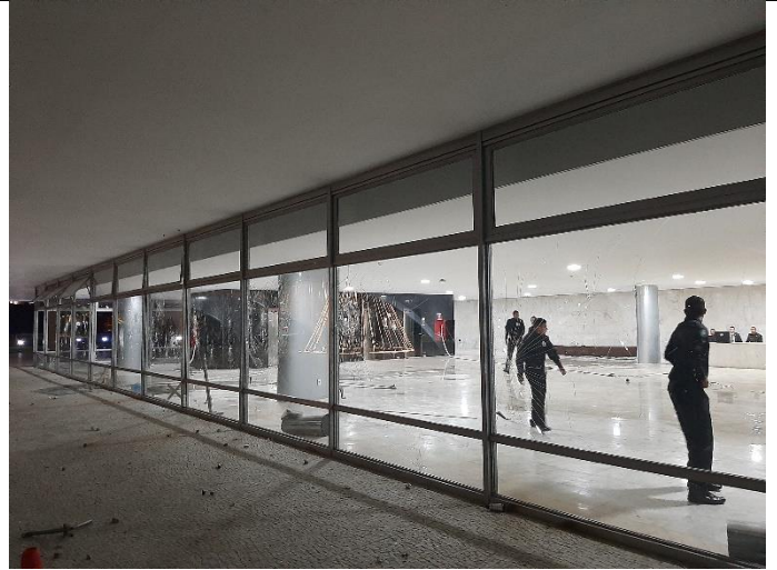
Vidros quebrados do térreo do Palácio do Planalto
