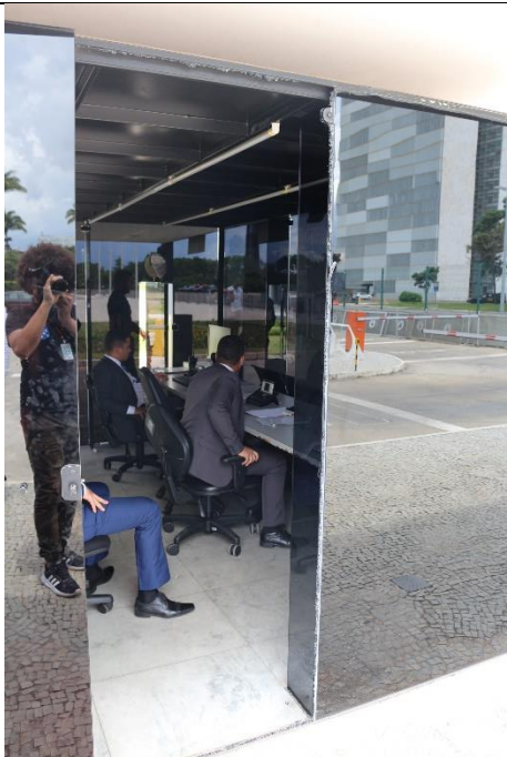
Vidro quebrado, na guarita de entrada do Palácio
