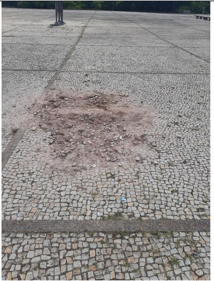
Trecho do piso com pedras portuguesas arrancadas
