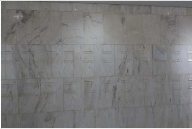
Galeria de fotos vandalizada e parede de mármore danificada
