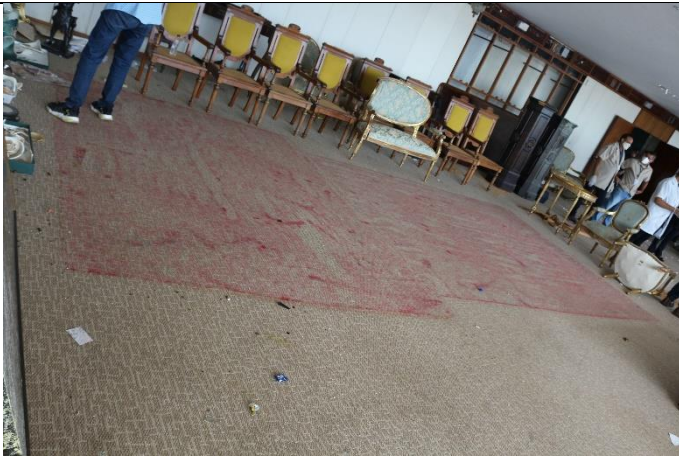
Salão Nobre com carpete manchado e encharcado
