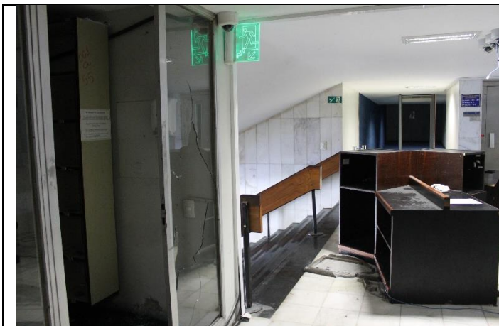
Danos em esquadrias internas
