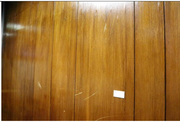
Danos em painéis de madeira causados por vândalos
