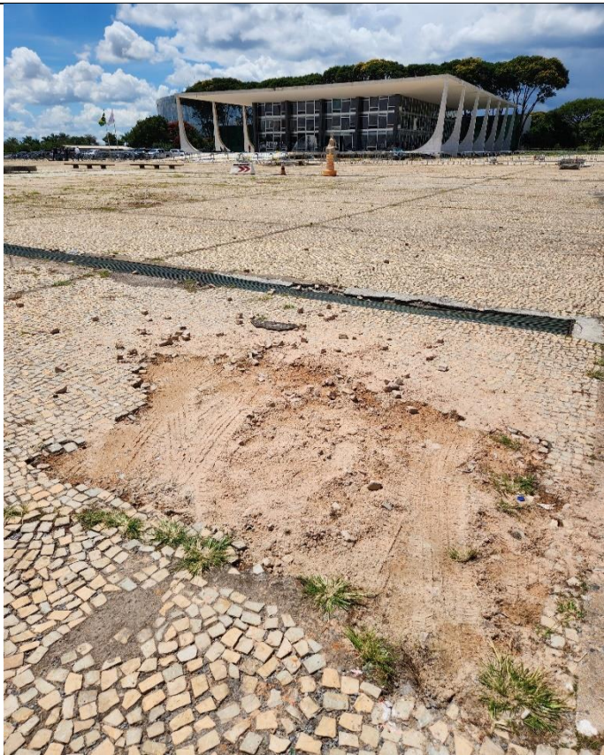
Trecho do piso com pedras portuguesas arrancadas
