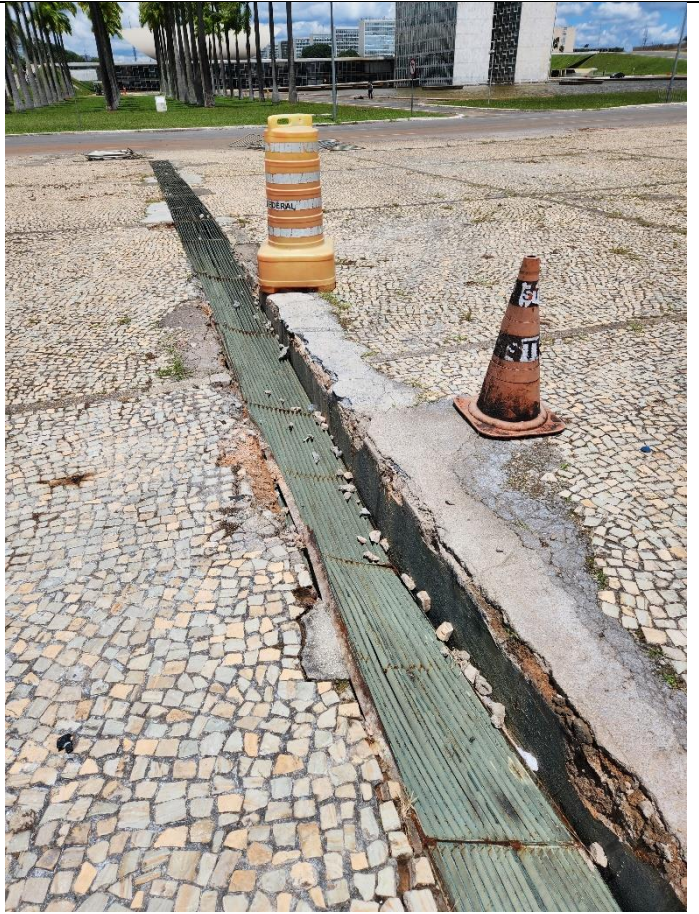
Grelhas de escoamento danificadas
