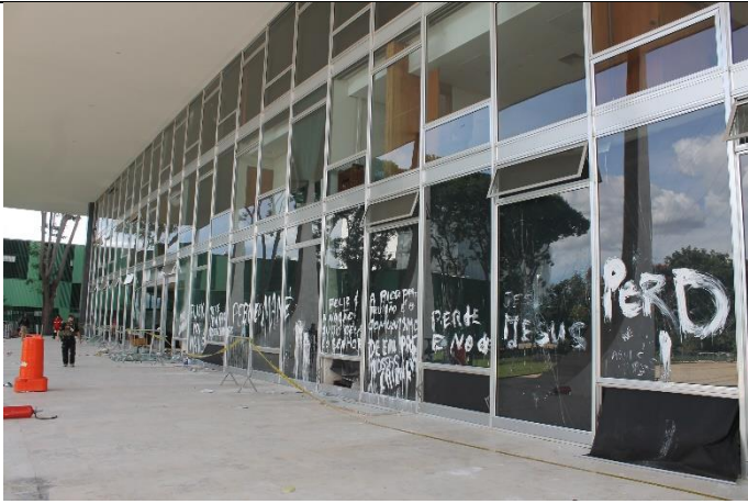
Fachada leste com pichações, esquadrias danificadas, vidros trincados e quebrados
