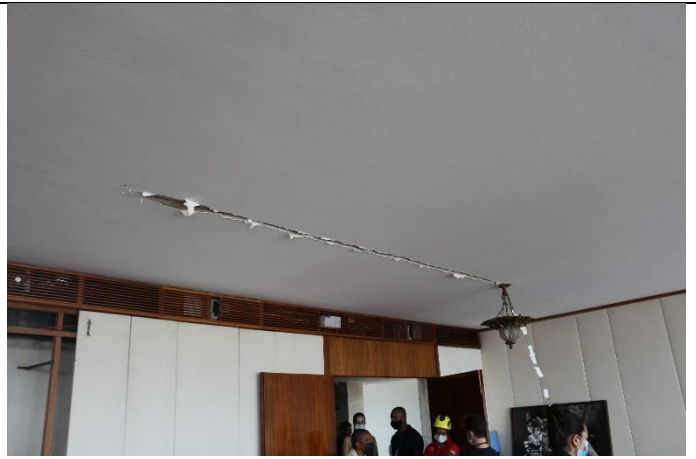
Salão Nobre com forro depredado
