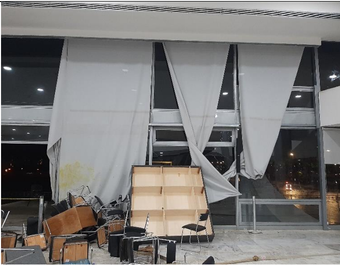
Mobiliário e cortinas vandalizados, à frente de vidros quebrados
