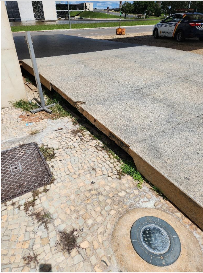
Rampa do Museu da Cidade com parte da pedra de revestimento arrancada
