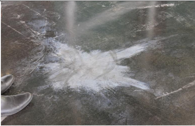
Dano em piso provavelmente causado por deflagração de bomba de efeito moral
