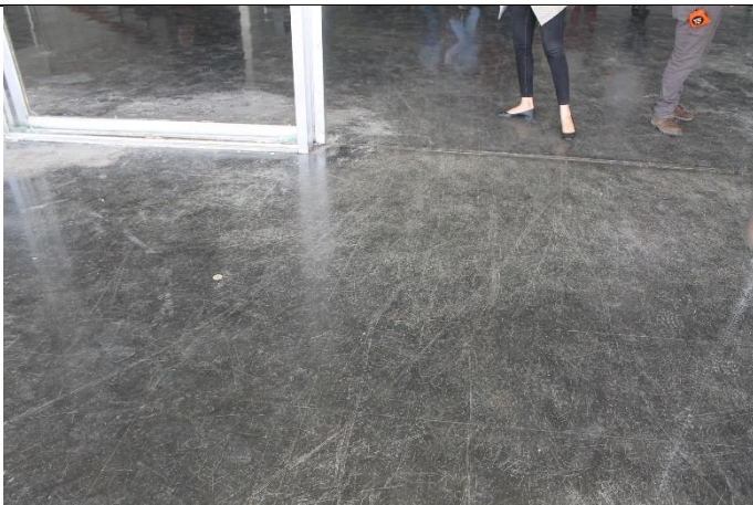
Piso danificado pelo atrito dos estilhaços da esquadria
