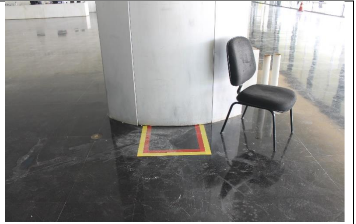
Danos ao piso do Congresso
