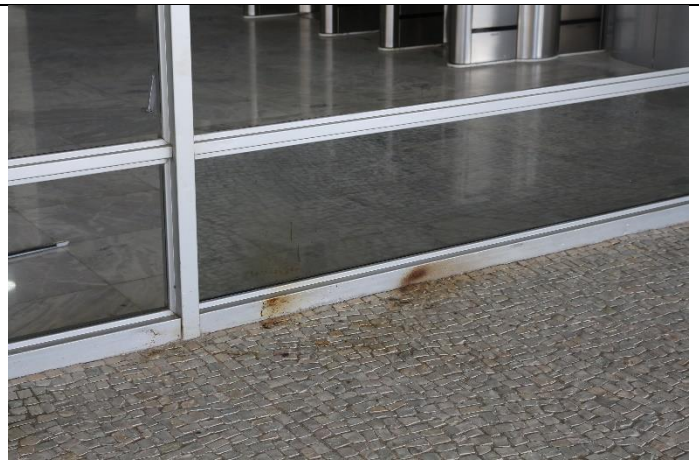
Manchas de fogo no piso e esquadrias, causadas, provavelmente, por bombas de efeito moral
